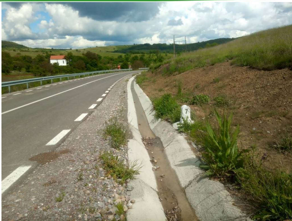
Fig. 13 Situația existentă a sectorului de drum la momentul vizitei în teren, pe fiecare zonă delimitată, funcție de problemele identificate
